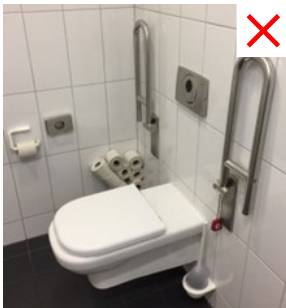
Inodoro suspendido largo. No dispone de apoyo cómodo para la espalda
