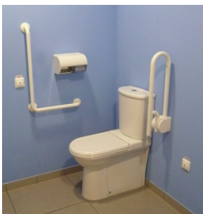
Inodoro con pulsador de emergencia.
