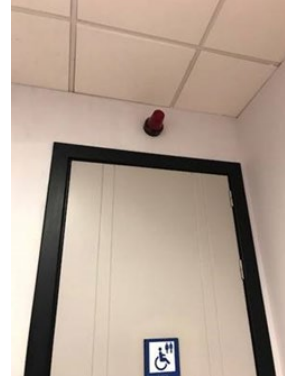
Señal lumínica y sonora situada en zona visible exterior y/o conectada a una zona de control o recepción.
