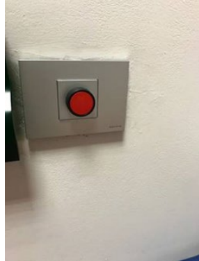
Pulsador: de corte de la señal situado en el exterior de la cabina.
