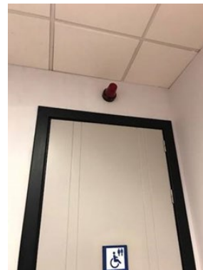
Señal lumínica y sonora situada en zona visible exterior y/o conectada a una zona de control o recepción.
