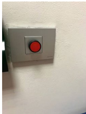
Pulsador: de corte de la señal situado en el exterior de la cabina.
