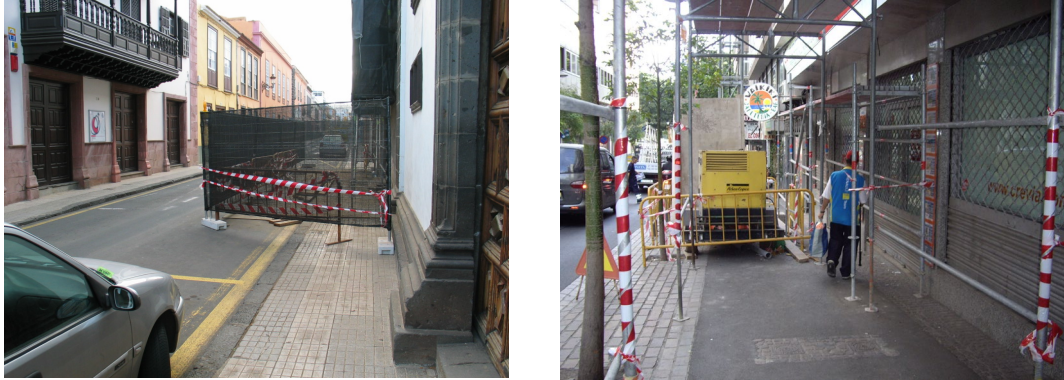
Obras que invaden el itinerario peatonal accesible
