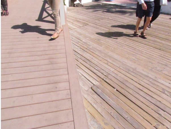
Pavimento de madera sin mantenimiento
