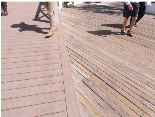
Pavimento de madera sin mantenimiento
